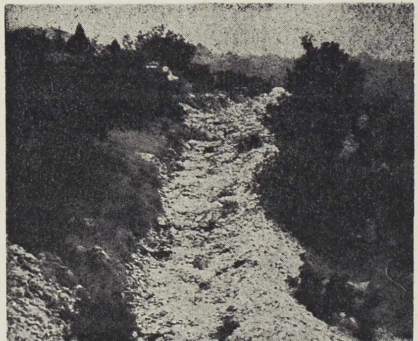
ŽEDNE CIJEVI — na dužini od oko 11 kilometara postavljene su vodovodne cijevi. Sada je na redu izgradnja rezervoara, pa će se Rogozničani napiti pitke vode. Tako će se konačno ostvariti njihov san i biti nagrađeni višegodišnjim trudom
